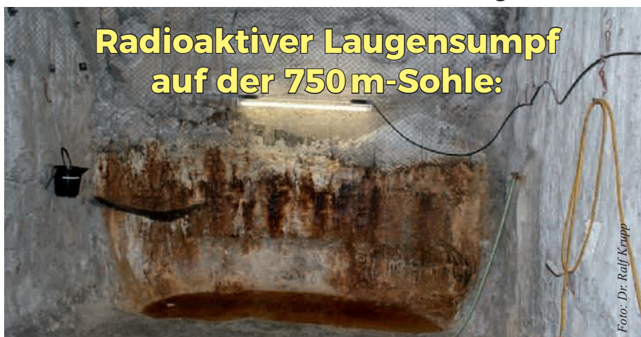
Hier will das BfS verfüllen. Radioaktive Laugen treten aus, vermutlich stammen sie aus der Atommüllkammer 10 auf 750 m und laufen durch Kammer 9. Rostpartikel deuten auf eine Korrosion der Atommüll-Fässer. Nach der Verfüllung könnten sich Laugen in der Einlagerungskammer aufstauen und den Atommüll vernässen oder ihn gar auflösen.
